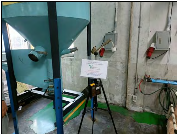
ภาพที่ 21 การเก็บตัวอย่างฝุ่นละอองรวม บริเวณ อาคาร A - ห้องโม่ผสม
