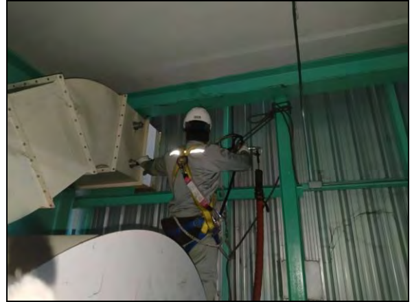
ภาพที่ 14 การเก็บตัวอย่างอากาศจากปล่องระบายอากาศ Exhaust Mixing No.1 (Plant E)
