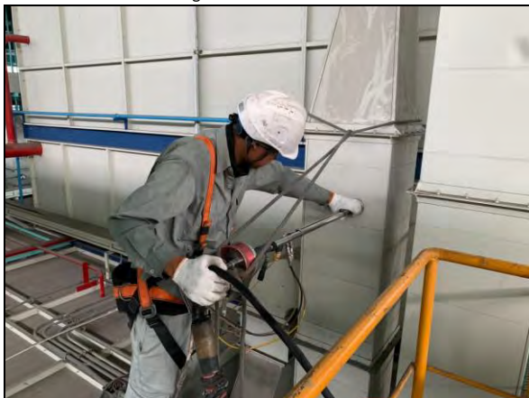
ภาพที่ 11 การเก็บตัวอย่างอากาศจากปล่องระบายอากาศ Exhaust Fan Setting Base & Clear No.9 (Plant C)
